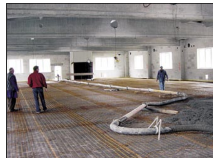
Betoniranje kombinirano armirane in omejeno skrčljive cementnobetonške plošče d = 8-10 cm na stropu iz PVP montažnih predizdelanih plošč preko ločilne folije z učinkom dušenja zvoka (silent).
