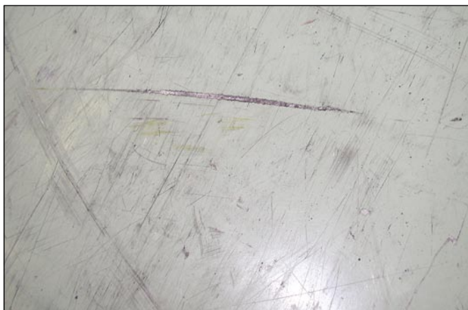
Močno obremenjen cementnobetonški tlak z epoksidno prevleko
