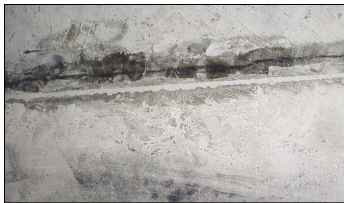
Razpokan, nepravilno dilatiran in nepravilno saniran tlak z neustrezno izvedbo visokovrednega posipa TAL M-KVARC (sveže na sveže)
