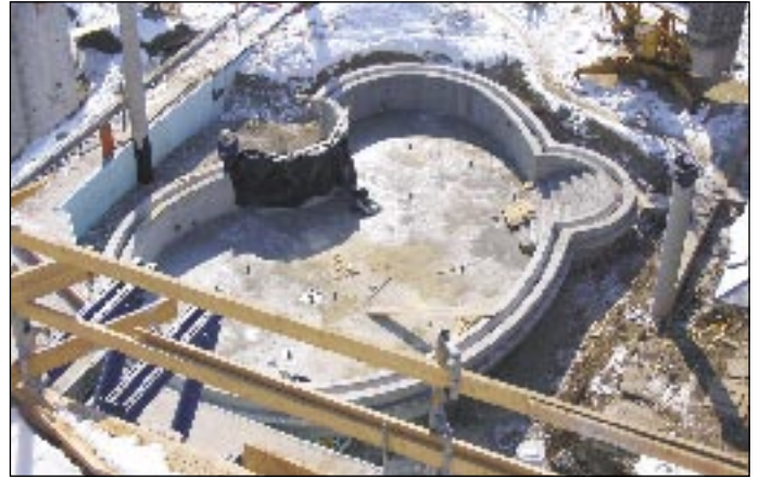
V zimskem obdobju je mogoče izdelovati tudi najzahtevnejše vrste betonov – objekt Wellness center Terme Čatež; gradil ga je Begrad, d.d. (dodatek Cementol Omega F – kombinacija pospešila strjevanja z učinkom superplastifikatorja).
