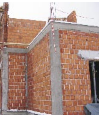
Zimsko zidanje z opečnimi bloki na objektu Mednarodni železniški mejni prehod MŽMP v Dobovi; gradil ga je Begrad, d.d. (dodatek za podaljšane malte – pospešilo vezanja Cementol Omega P)
