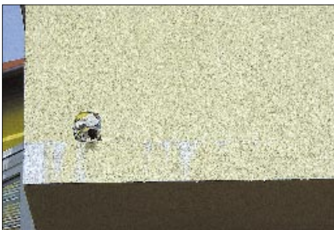
Poškodbe na pozidanem parapetu balkona zaradi nepravilno izvedenega odtoka in hidroizolacije (v zimskem času se bodo poškodbe še povečale).
